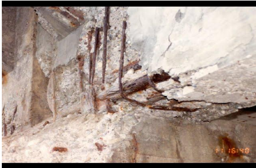
Figure 1 : corrosion de l'armature de béton armé
