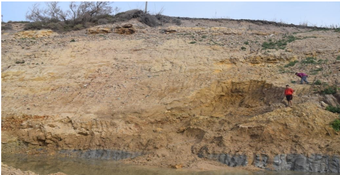
Ecroulement de sable au niveau du talus n°. 1
