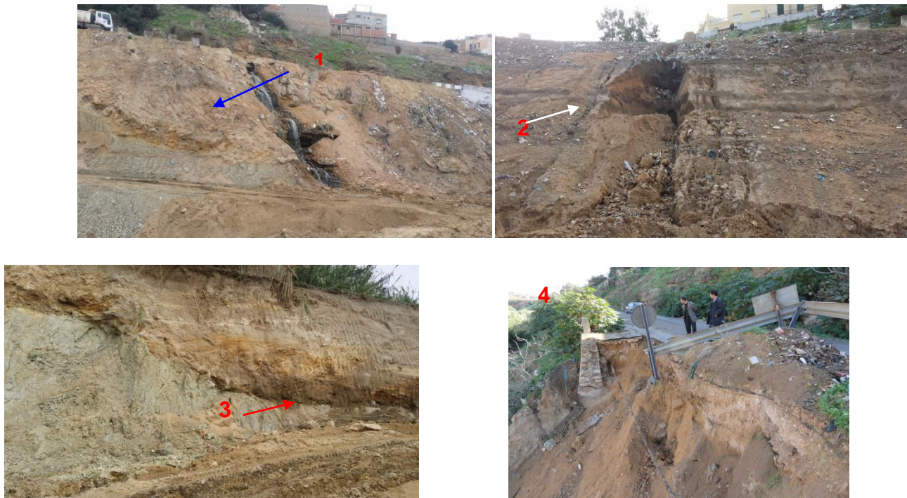
Figure IV .6: Présentations photographiques de certains aspects d'instabilité au niveau de la région d'étude.
