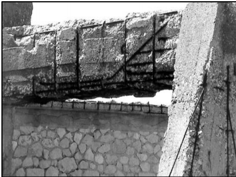
Figure.II.5. La dégradation d'une poutre en béton armé en milieu salin (Yahiaoui, 2001)
