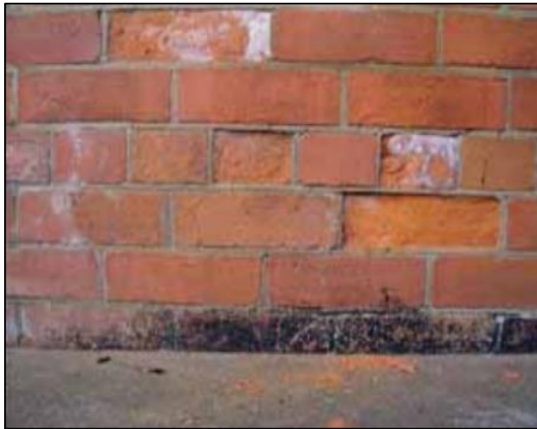
Figure.II.6. La dégradation d'un mur en brique par accumulation de sels (Slinger et Tenison, 2007)
