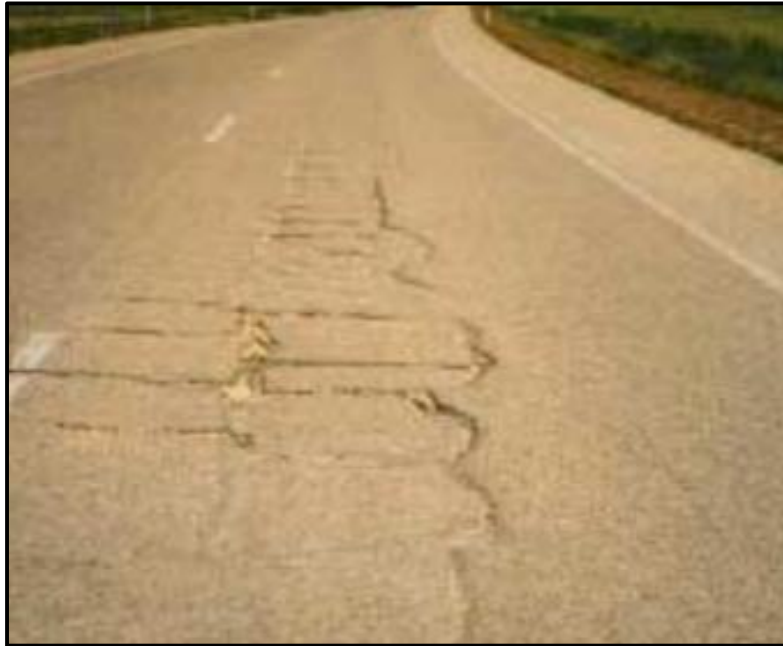
Figure. II.4. La dégradation de la couche de roulement d'une route en raison de la remontée d'eau saline (Vorobieff et al., 2001)
