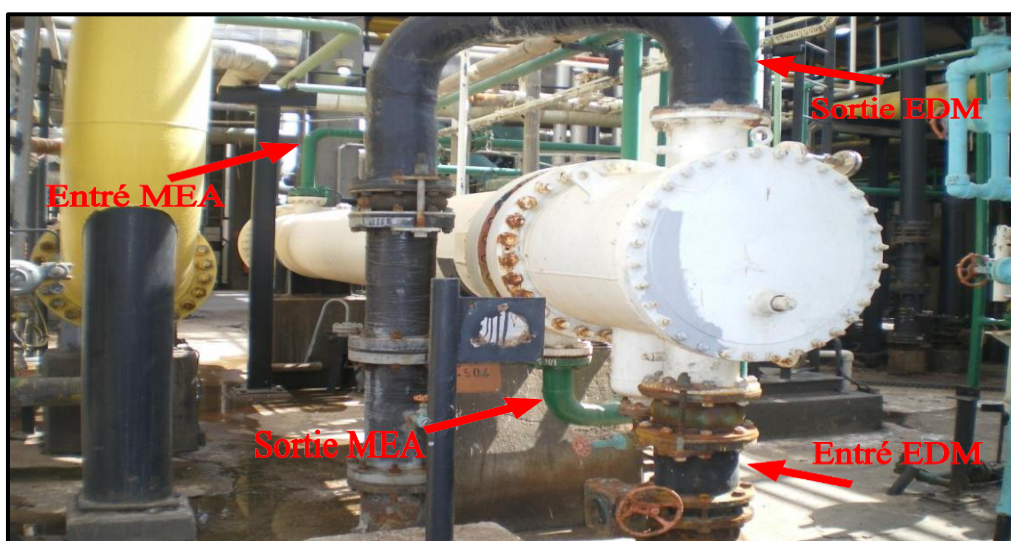
Figure II.2: L'échangeur de chaleur E504 dans la section décarbonation.
