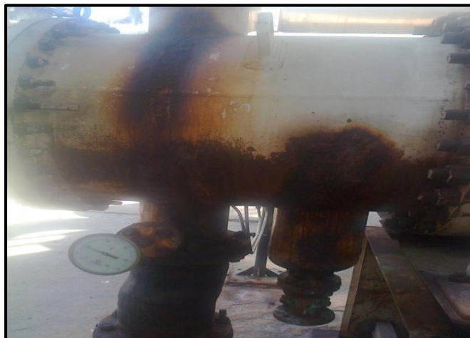
Figure III.7. la corrosion sur la boîte de distribution d'échangeur E504.
