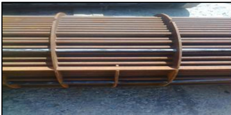
Figure III.4. l'effet de la MEA sur la surface des tubes d'échangeur E504.
