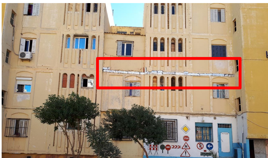
Figure 95: Problème d'étanchéité au niveau des parois extérieures, Cas des ZHUN cité 5 juillet Mostaganem. Source : Auteur
