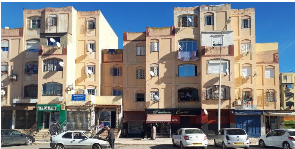
Figure 98: Exemple des façades d'une ZHUN à Mostaganem, cas la cité 5 juillet. Source : Auteur
