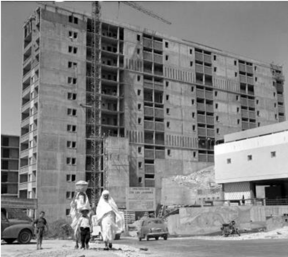
Figure 73: Bloc d'immeubles en construction en application du plan de Constantine, juillet 1959, Alger.
