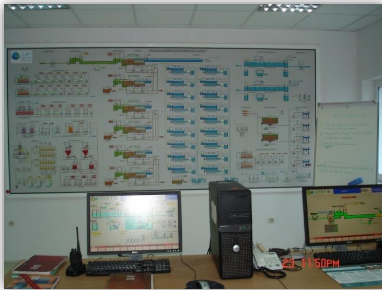
Figure. II.11 Salle de contrôle
