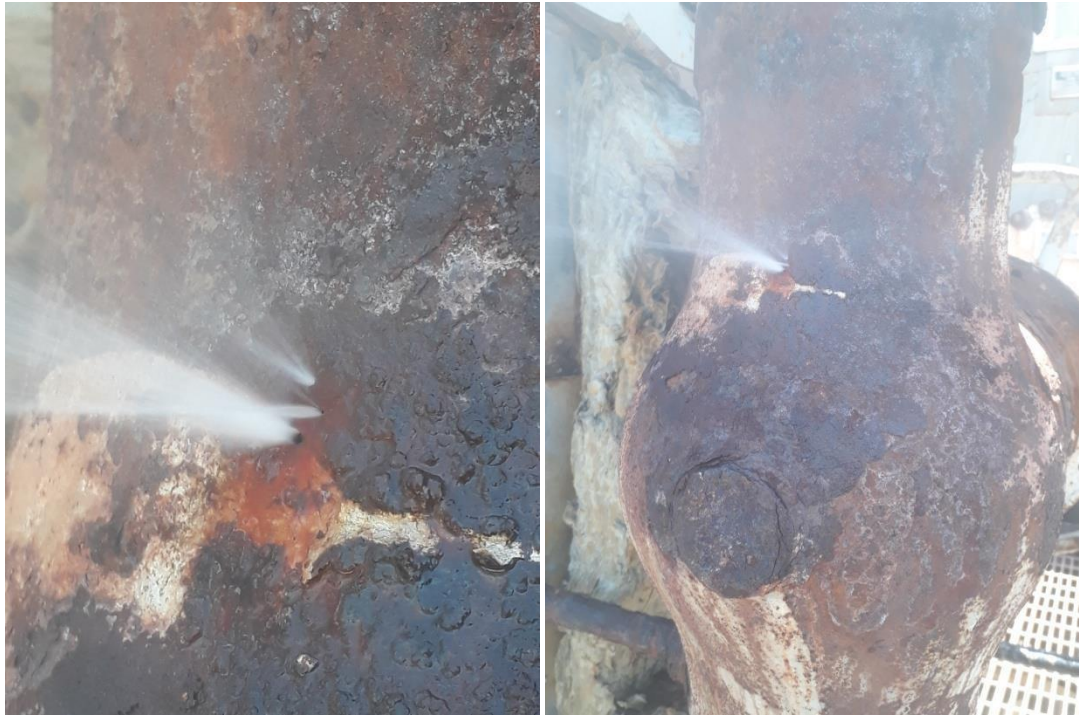
Figure III.2 : Effet d'une corrosion par piqûre.
