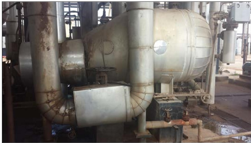
Figure I.7 : Chaudière de récupération EB101
