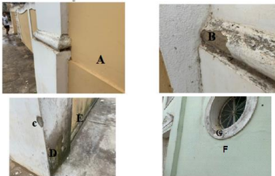
Figure III.7: Pathologie détectée par observation visuelle [14]
