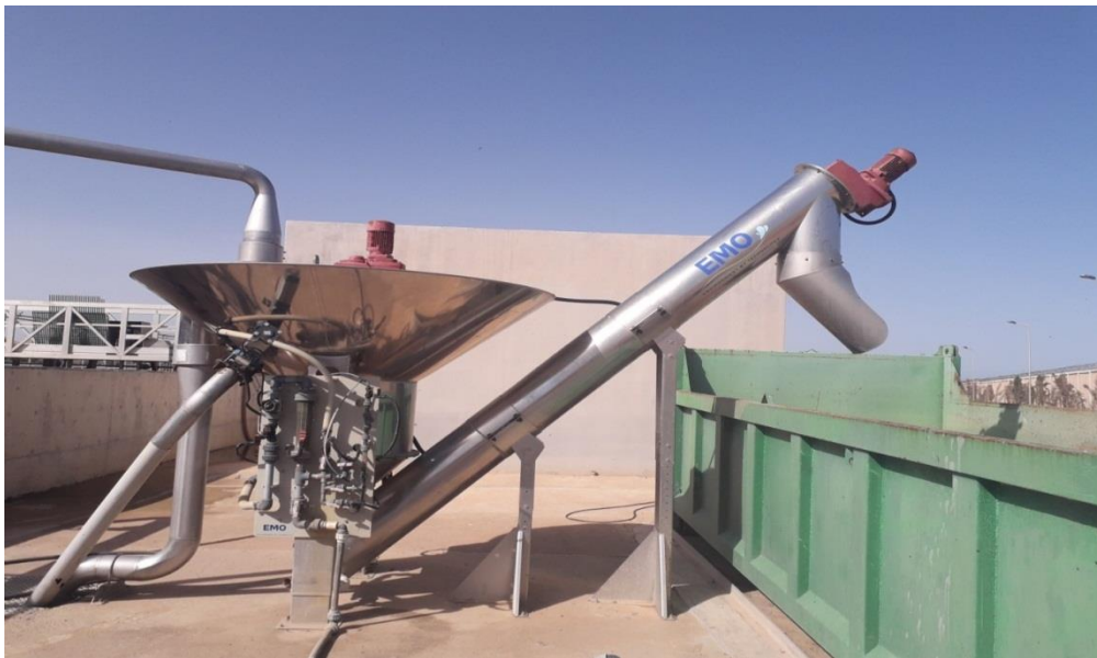
Figure 10 : clarificateur de sable.
