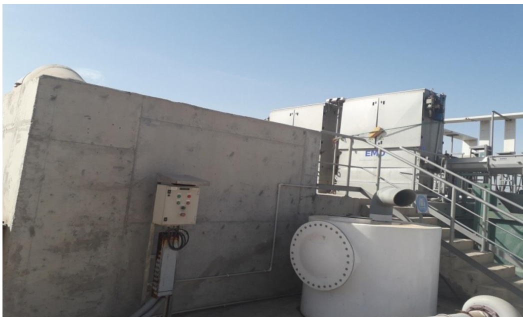
Figure 9 : Dégrillage grossier et fin.
