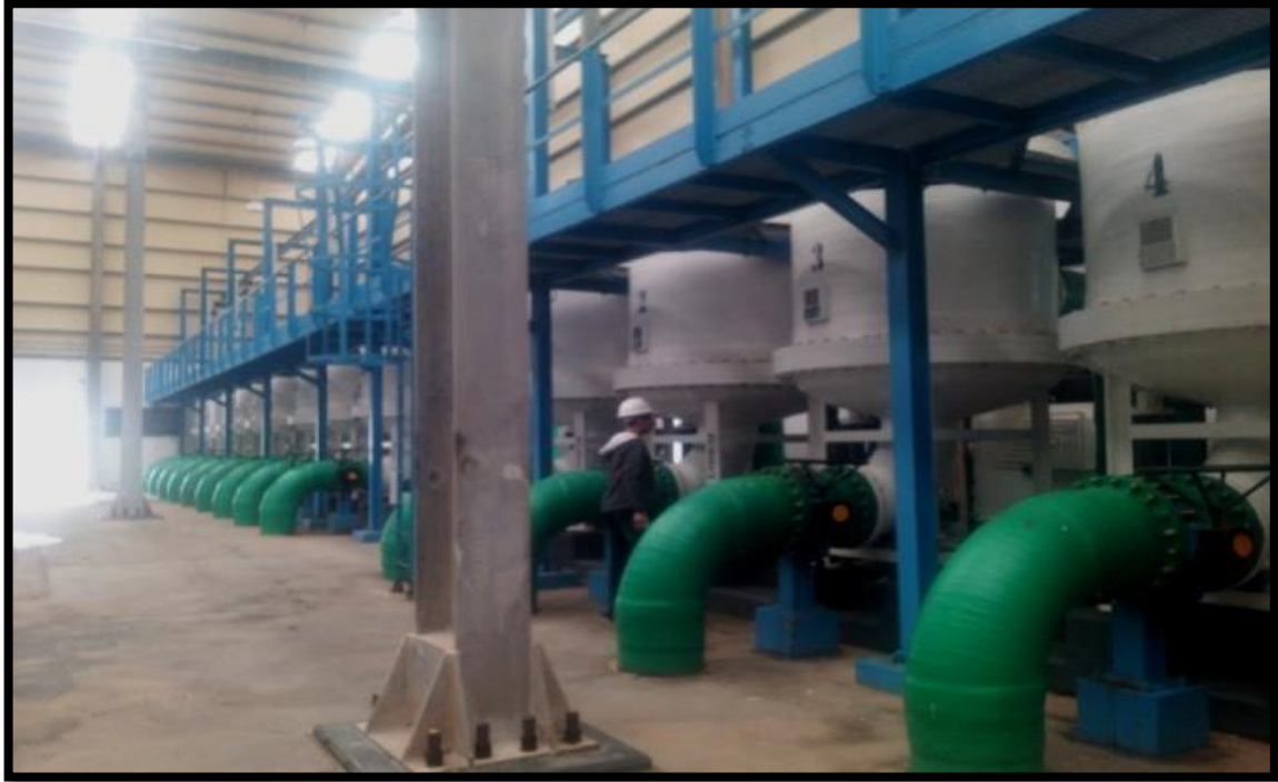
Figure 10 : Système de microfiltration (9 filtres)
