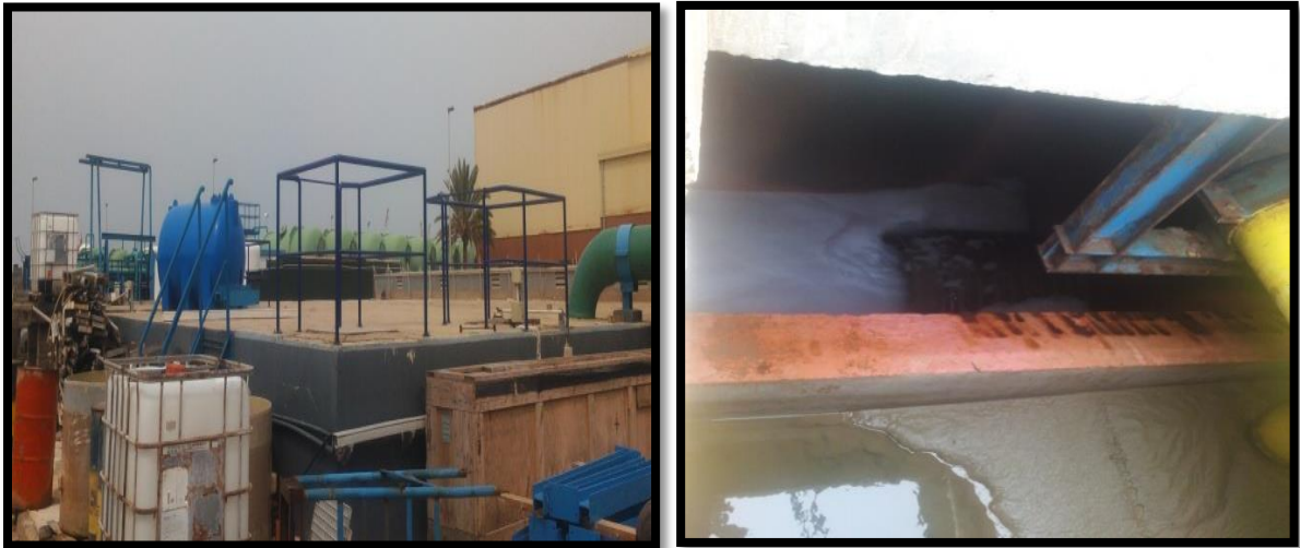
Figure 15 : R éservoir de Saumure (point de sortie des rejets)
