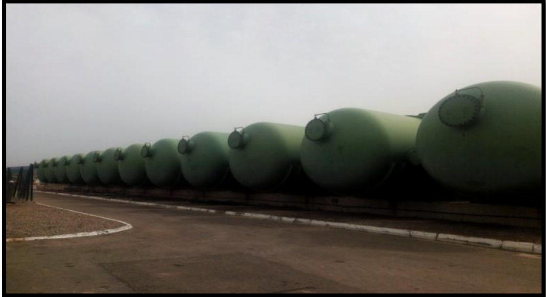
Figure 8 : Filtration de première étape (12 filtres)
