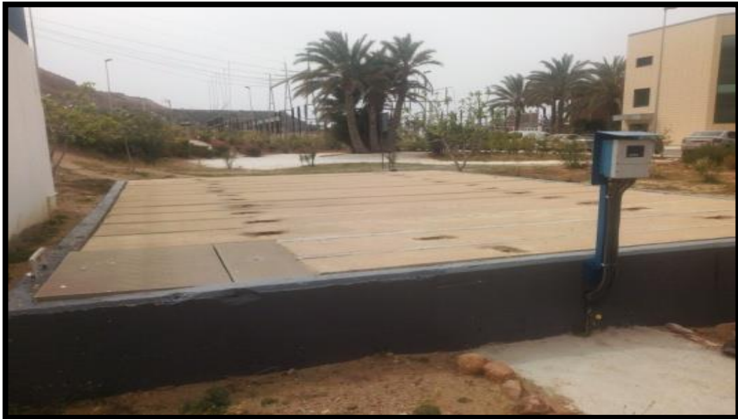
Figure 14 : Le système de stockage et impulsion de l'eau (point de sortie d'eau traité)
