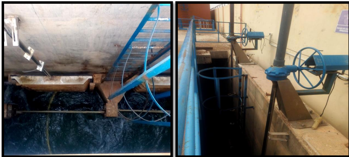
Figure 7 : le captage de l'eau de mer (point d'entrée de l'eau de mer)
