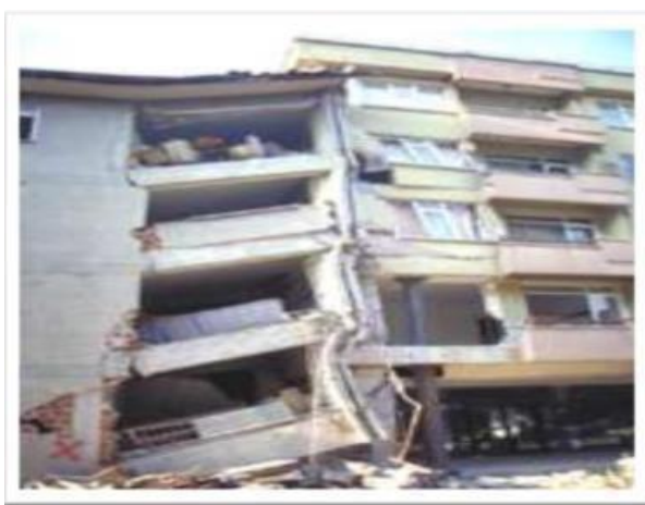
Figure 1.11. Endommagement et rotation des poutres
