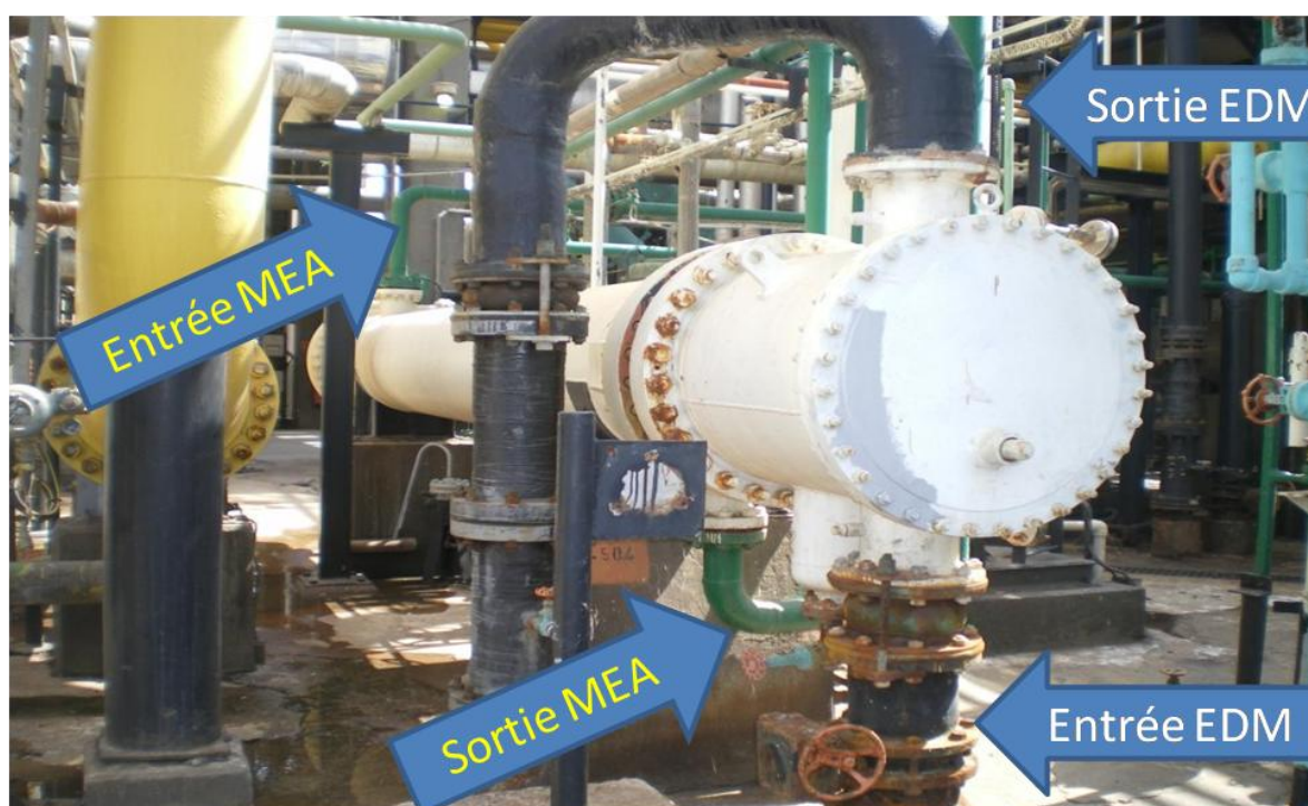
Figure 2.2: l'échangeur de chaleur E504 dans la section décarbonatation
