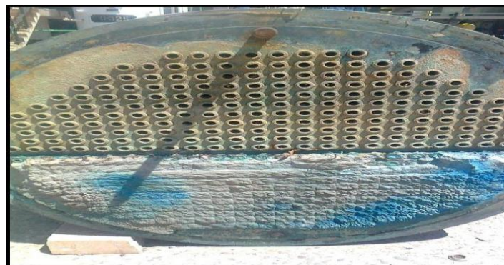
Figure 3.1: Dépôt de tartre formé sur les faisceaux tubulaires de l'échangeur
