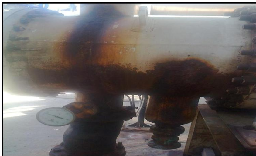
Figure 3.6 : La corrosion sur la boîte de distribution d'échangeur E504
