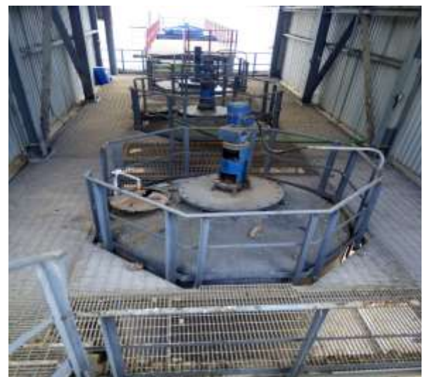
Figure I.10 Cuve (réacteur) de traitement
