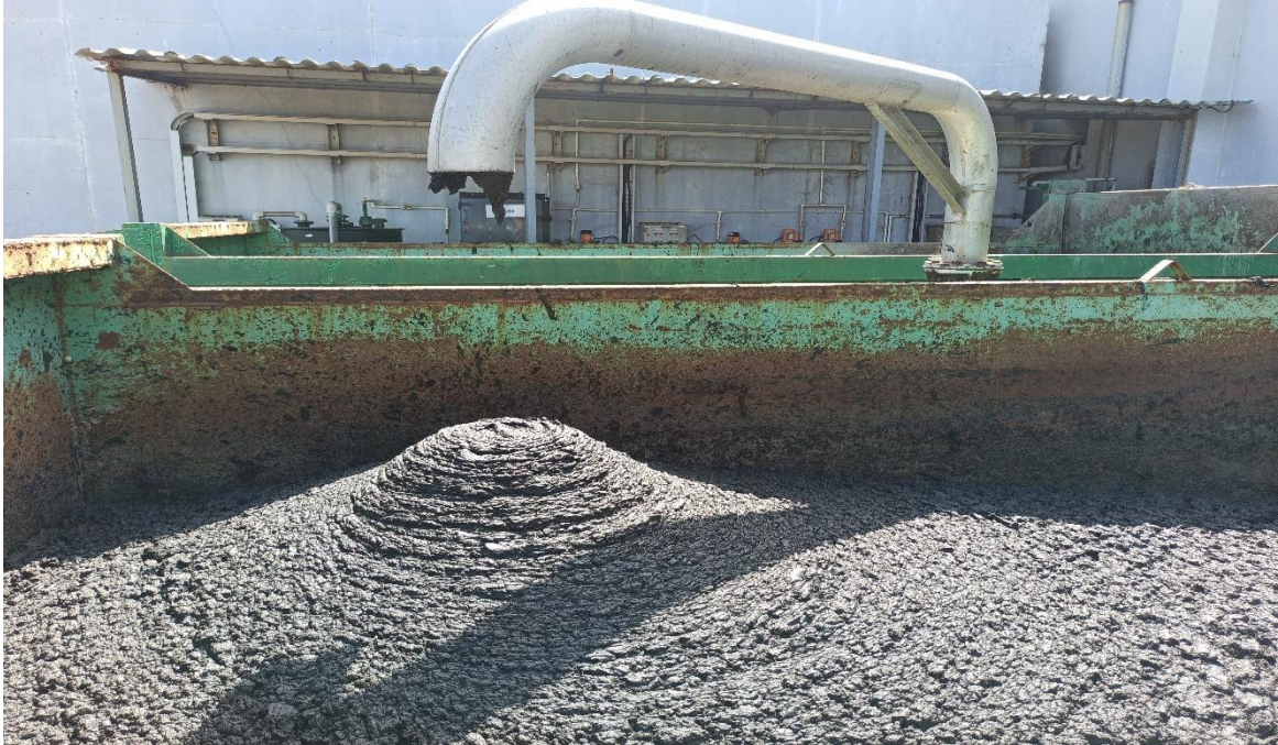
Figure 13 : la sortie de la boue séchée.
