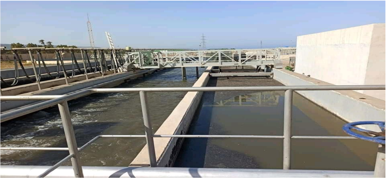
Figure 9 : Bassin de désinfection.
