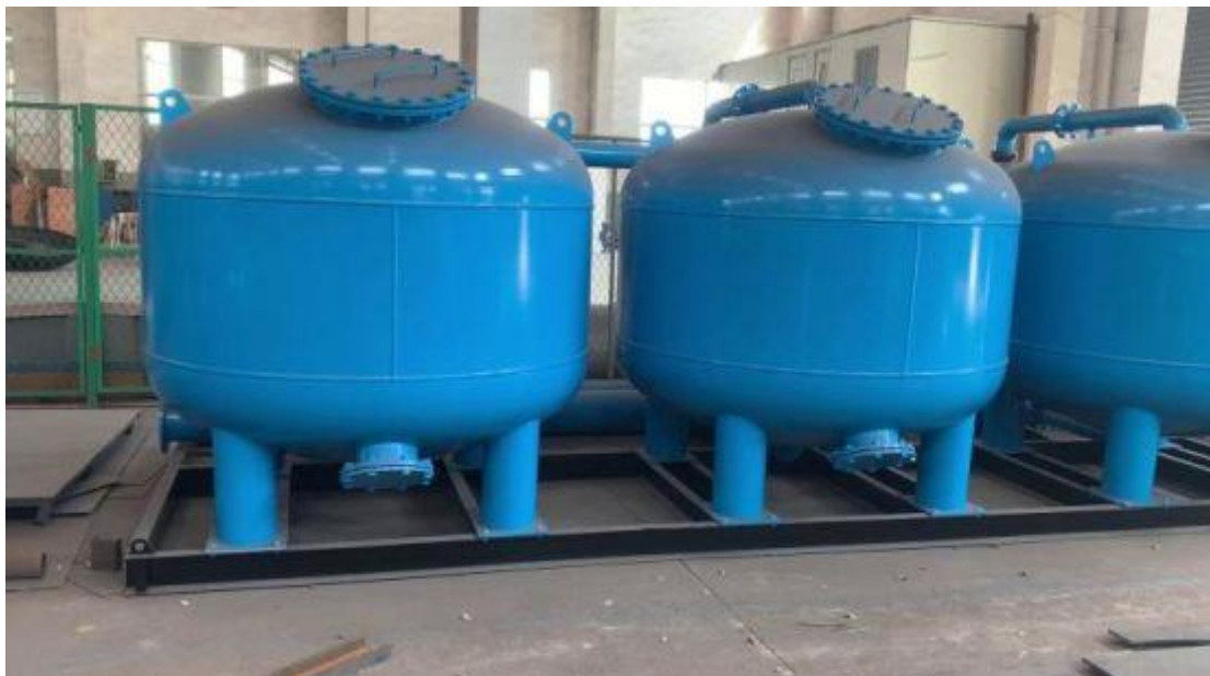
Figure II.4 : Réservoirs d'eau filtrée
