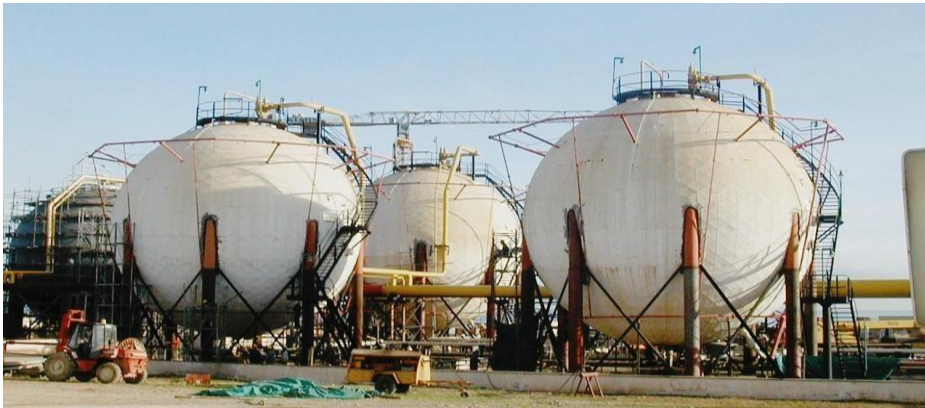
Figure I.4 : Sphères de stockage
