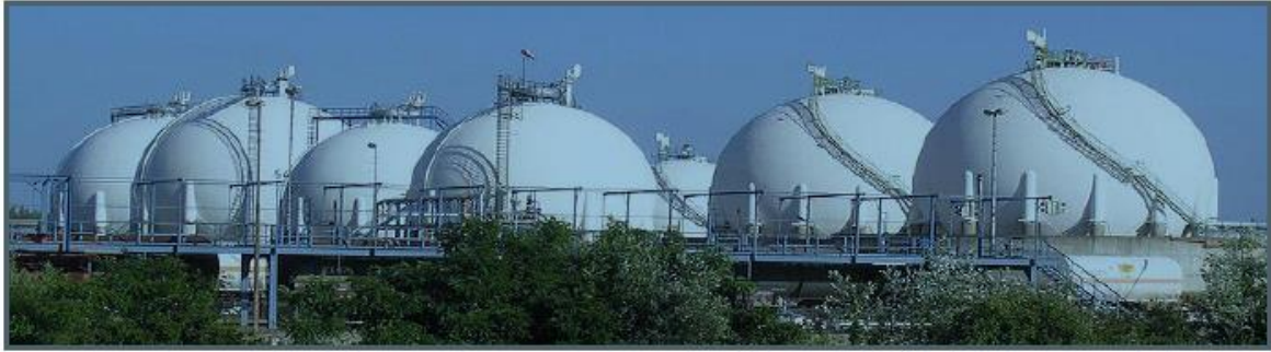
Figure. I.4 : Réservoirs de stockage de gaz. [10]
