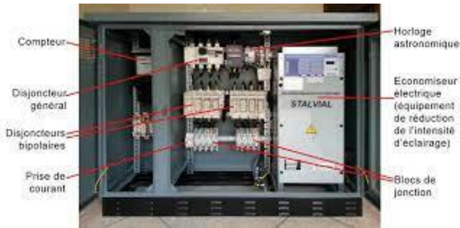
Figure1. 9: coffret de commande et de protection
