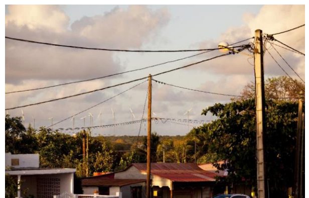
Figure 8 des câbles aériennes
