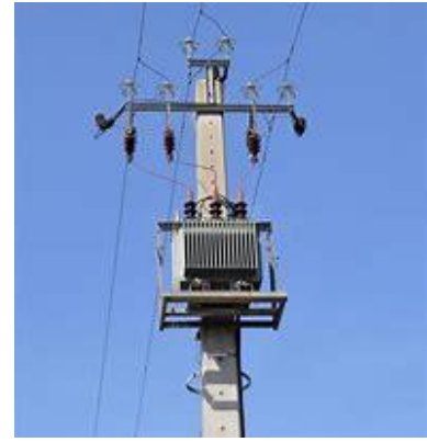
Console sur poteau de distribution
