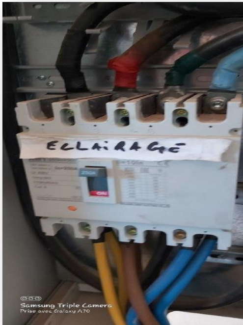
Figure III.7 : Sectionneur pour éclairage 250 A
