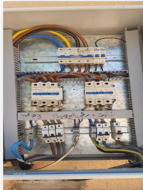
Figure III.7 : Armoire de commande pour éclairage
