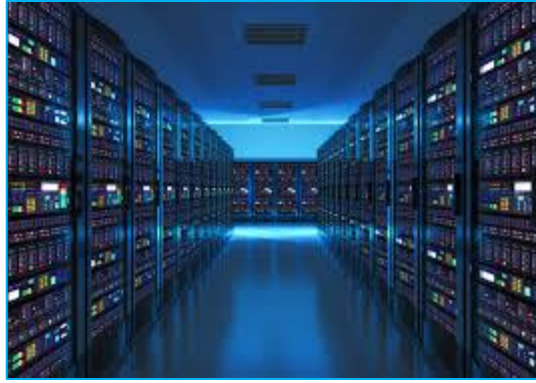
Figure 3. 14 : Image de serveur d'une centrale de calcul
