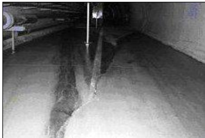
Figure II.7 : soulèvement puis dislocation du radier d'un tunnel (Robert et Fabre, 1987)
