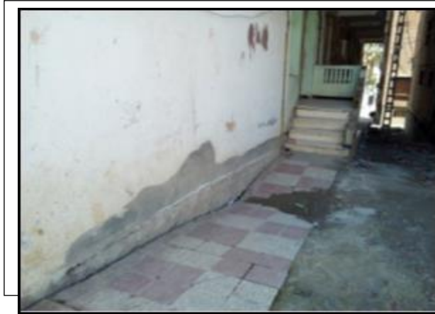
Figure II.2 : Désordres due au gonflement (Photo prise à Tizi-Ouzou)
