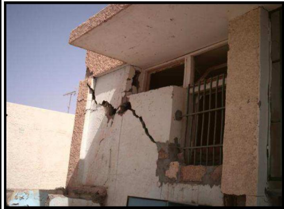
Figure II.3 : Fissure sur les murs (Zenk,2010)
