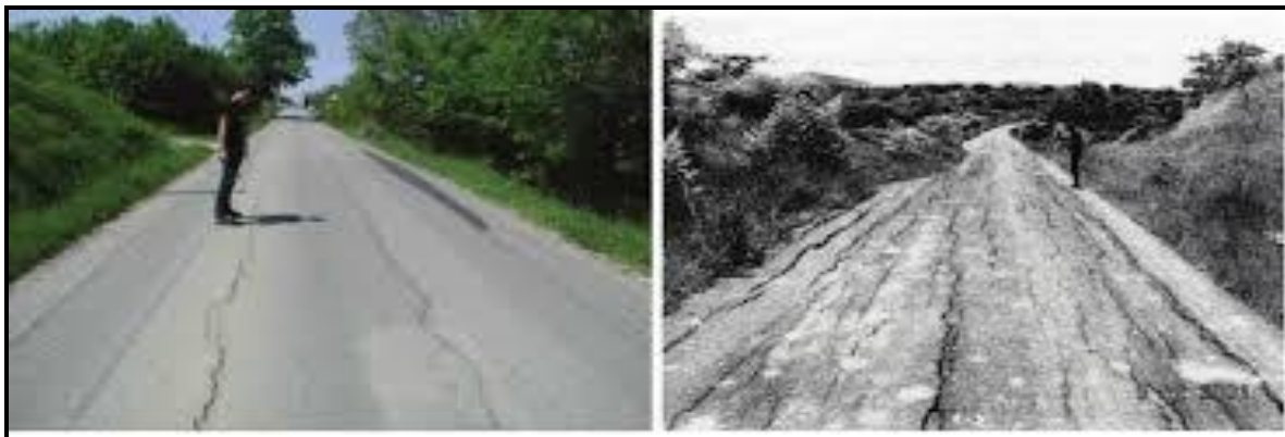
Figure II.5 : Fissures longitudinales sur routes due au retrait-gonflement de sol (a) en France (b) en Madagascar (Bekhouche ,2018)
