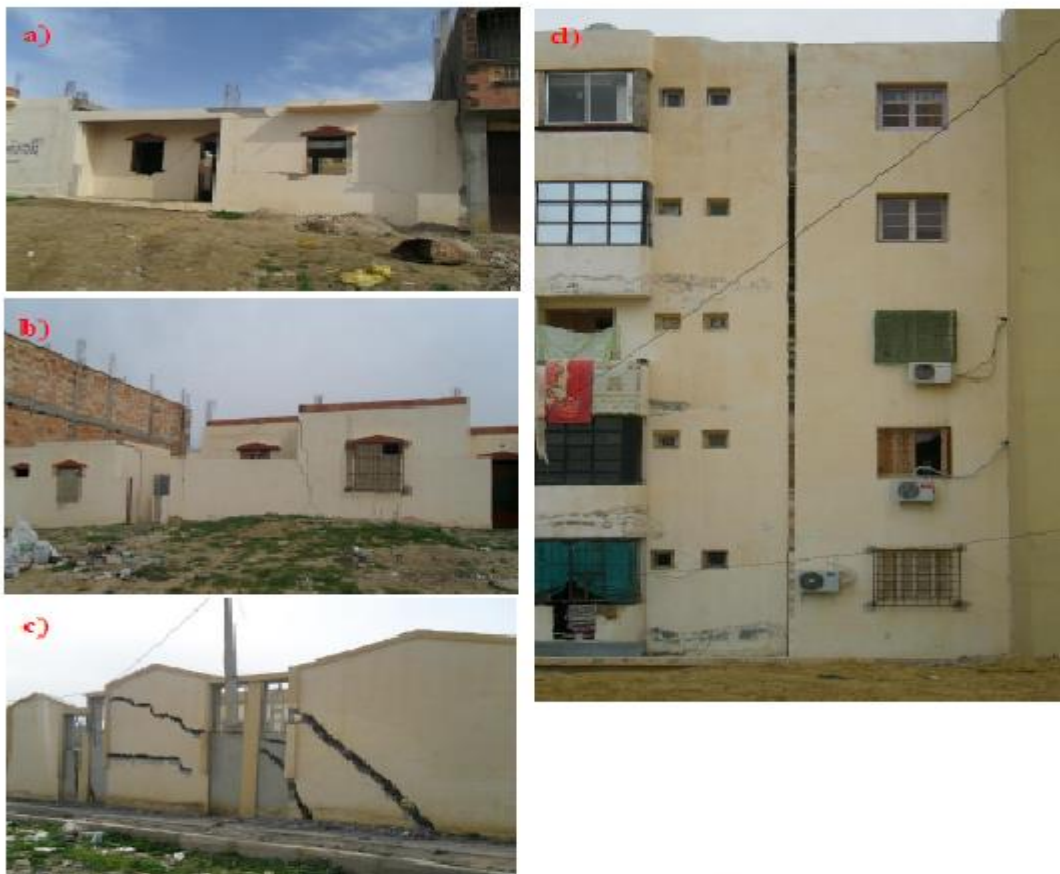
Figure II.4 : Désordres provoqué par la variation volumique du sol de fondation site de Sidi-Hadjrès à Msila ( MEKKI,2018)
