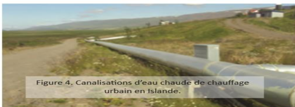
Figure 23. Canalisation d'eau chaude de chauffage de chauffage urbaine en Islande
