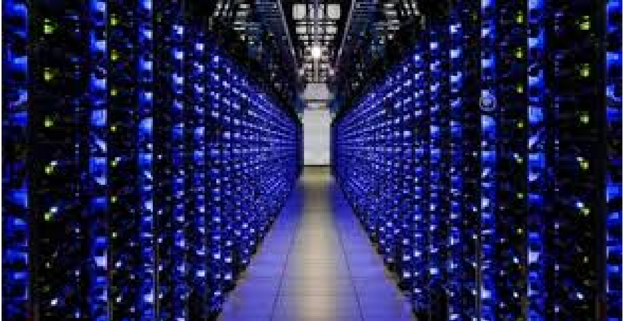
Figure 1.3 – centre de données(Data center)
