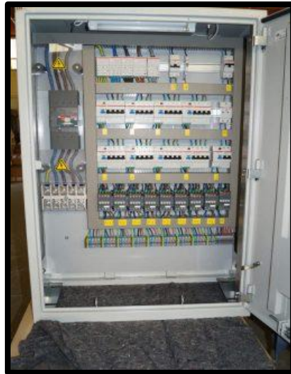
Figure II. 1 : Armoire pour l'éclairage public.
