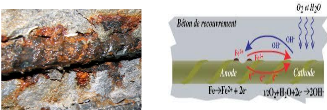
Figure I.8 : Dégradation due à la corrosion des armatures [44]
