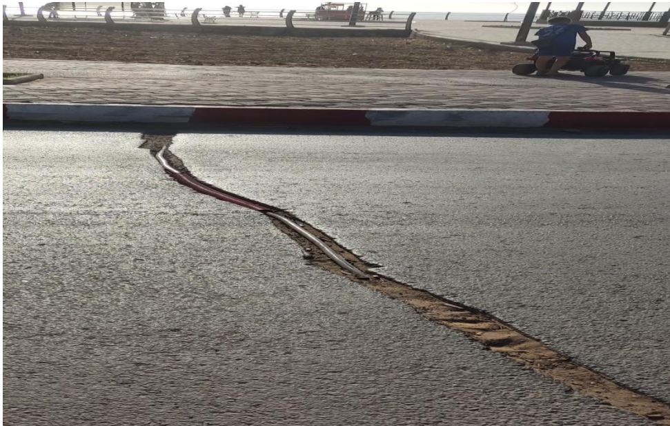
Figure II.15 : L'absence de protection
