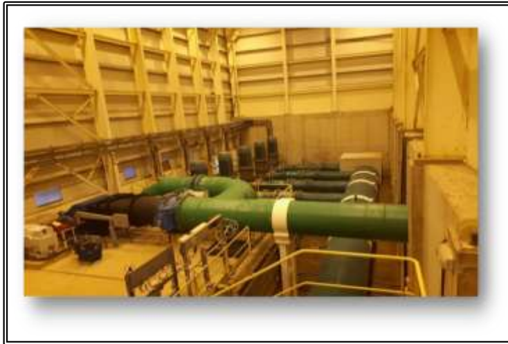
Figure II.8: Pompe de la captation de l'eau de mer.
