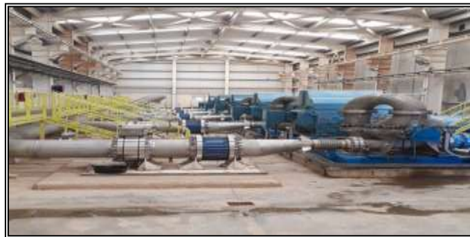
Figure II.23: Pompe H pour la distribution de l'eau produite.
