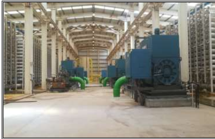
Figure II.16: Bâtiment d'osmose inverse.
