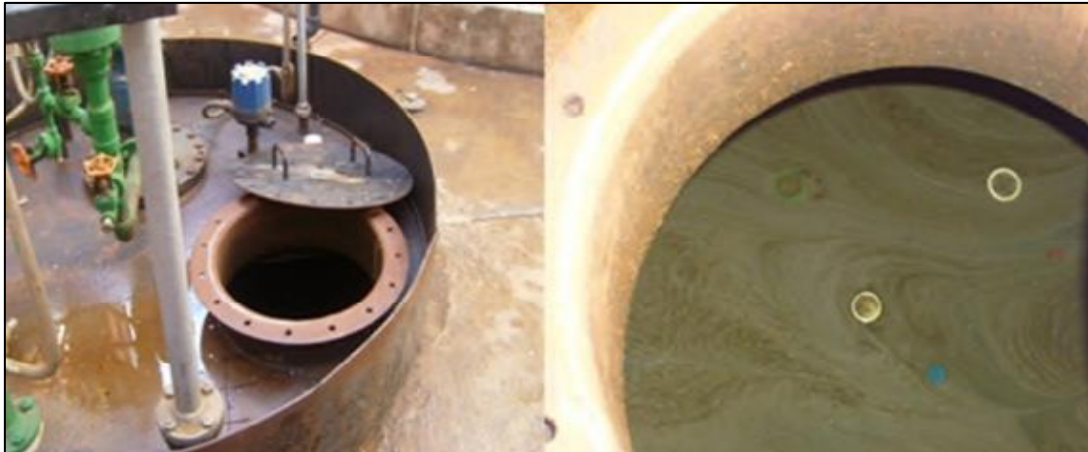
Figure II.2. Photographie de la contamination du puisard de MEA par l'huile
