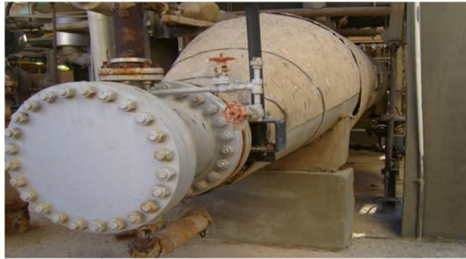
Figure I.7. Vaporisateur au niveau de GL2/Z.
