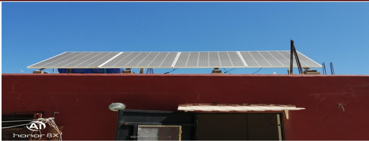
Figure III-1 : les panneaux solaires
