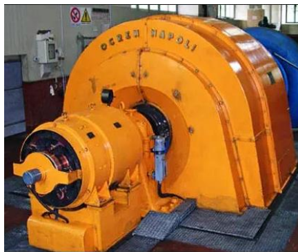
Figure I-20 : alternateur d'une centrale hydraulique [23]
