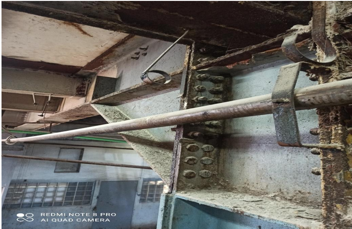
Figure III.9 : corrosion des boulons d'assemblage.
