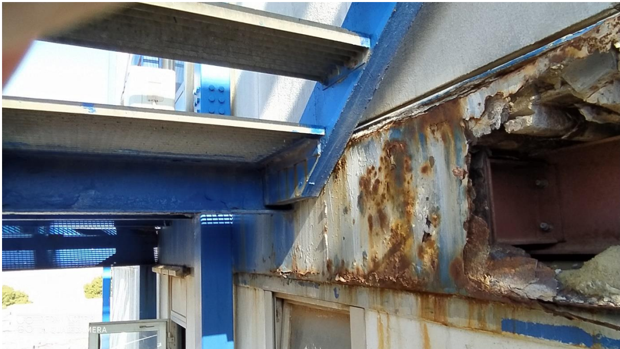
Figure III.3 : corrosion des éléments de la charpente de L'hôpital d'Ain Tedles.
