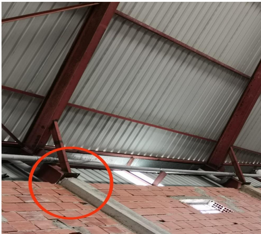
Figure III.13 : Absence de montage avec vis
