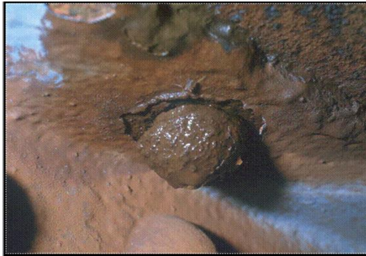
Figure II.13 : Desserrage de rivet suite à rouille [12].
