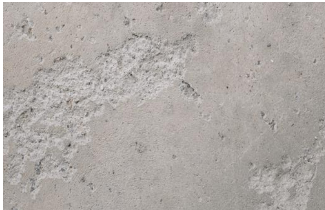
Figure II-6: Les cycles de gel-dégel peuvent causer l'entartrage des surfaces en béton
