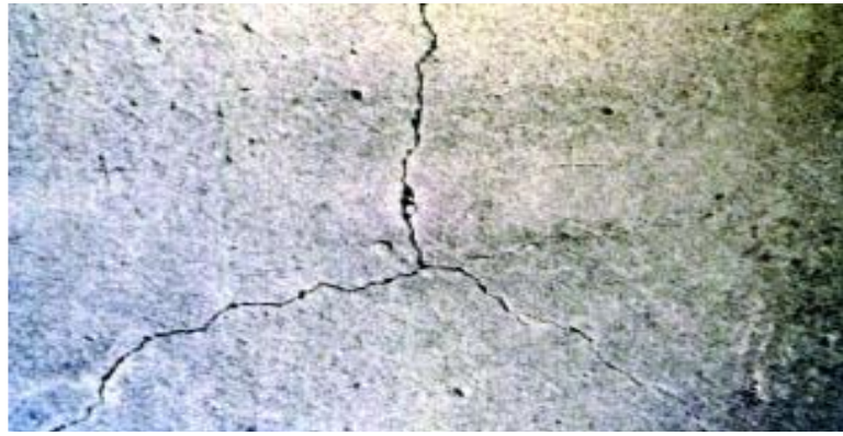
Figure II-11: La restriction au retrait de séchage est la cause la plus fréquente de fissuration du béton
