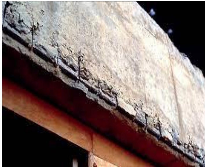
Figure II-5: La corrosion induite par la carbonatation se produit souvent sur les façades des bâtiments avec une couverture en béton peu profonde
