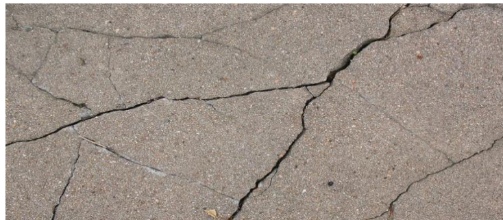
Figure II-9: Des fissures de retrait du plastique peuvent se produire lorsque l'eau s'évapore de la surface plus rapidement qu'elle n'est remplacée par l'eau de purge
