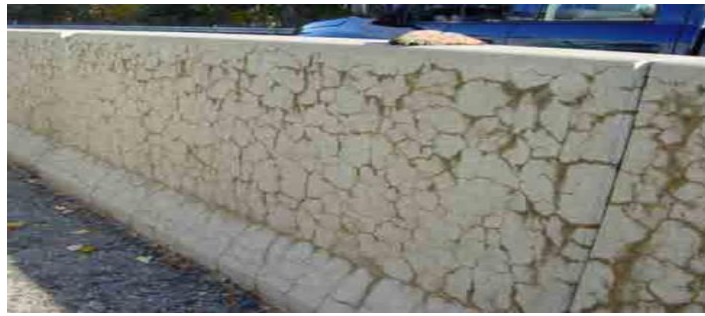
Figure II-7: Les indicateurs typiques de la réactivité alcali-silice sont la fissuration cartographique et, dans les cas avancés, les joints fermés et les surfaces de béton écaillées
