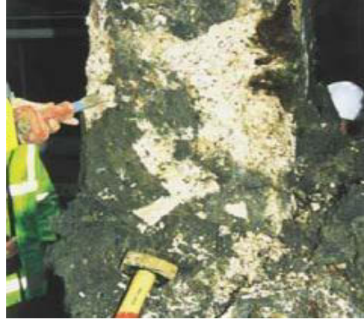
Dommages causés par la thaumasite
