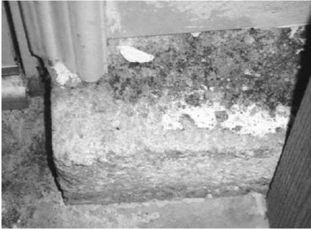
L'effritement et l'efflorescence
