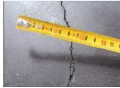
Figure I.26 : Ouverture importante des fissures de retrait [31].
