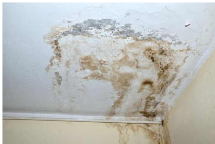
Figure I.11 : L'humidité des fuites [12].
