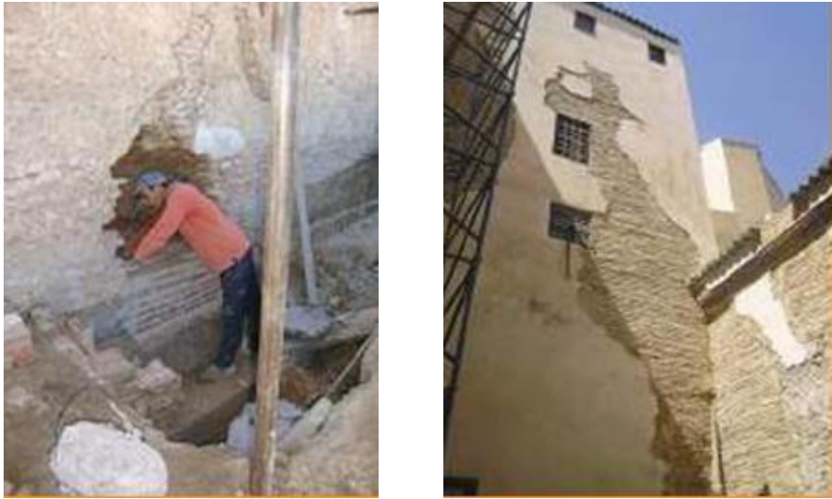
Figure III.33 : Deux exemples de cicatrisation de fissures sur façades d'édifices traditionnels [35].
