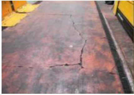
Figure I.25 : Retrait plastique à la surface d'une dalle en béton armé [31].
