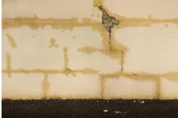
Figure I.6 : Exemple de fissure traversante. L'enduit est tombé autour de la fissure, laissant voir que cette dernière traverse également la brique. La présence d'humidité laisse comprendre que le mur souffre de capillarité [7].
