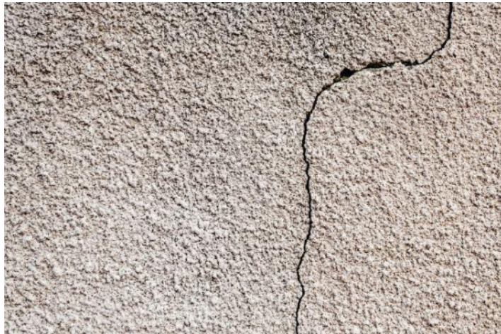
Figure I.3 : Fissure verticale dans un crépi de façade. L'épaisseur de la fissure peut laisser penser à un problème structurel [7].
