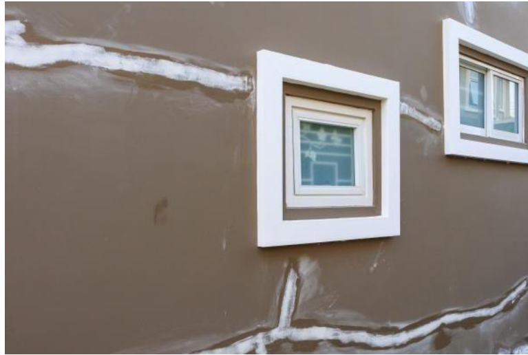
Figure I.4 : Fissure horizontale, rebouchée à l'aide d'enduit de réparation, suite à la correction de défauts de maçonnerie [7].
