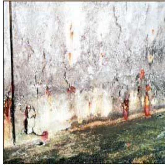
Figure I.14: Corrosion par piques liées aux chlorures [18].
