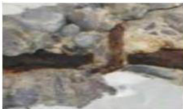
Figure I.19 : Éclatement du béton d'enrobage à cause de la carbonatation [29].
