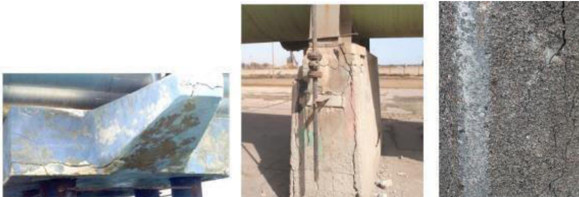
Figure I.21 : Conséquences de la carbonatation [31].
