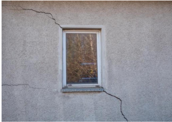
Figure I.2 : Fissure en moustache particulièrement grave. Ce type de fissure est clairement la preuve d'une maçonnerie pas adaptée à la menuiserie. La présence d'une fissure horizontale (sur la gauche de l'image) laisse à penser à de graves malfaçons [7].
