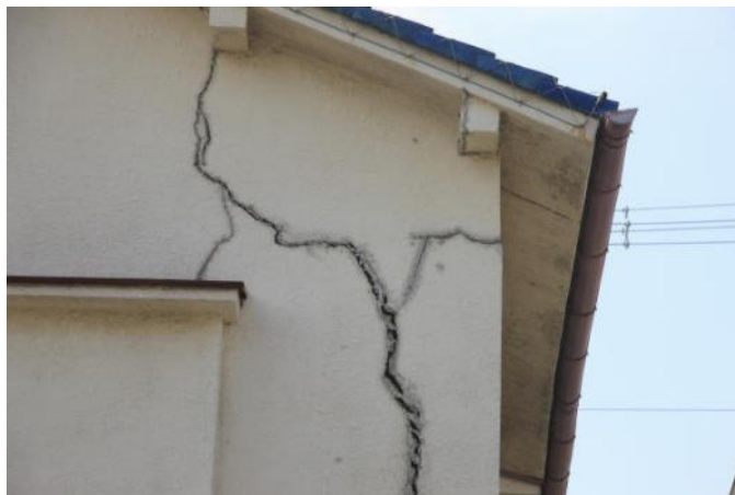
Figure I.7 : La lézarde est une fissure profonde et visible de loin. Ici, on aperçoit une lézarde de plusieurs centimètres de largeur [7].
