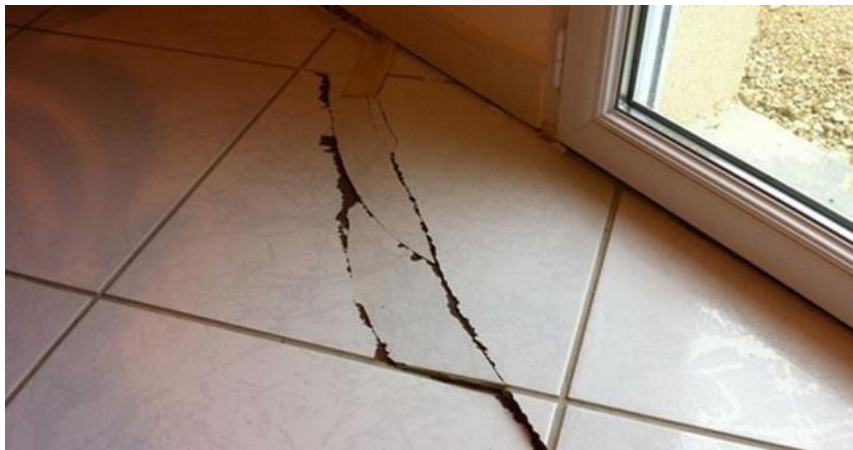
Figure I.12 : Désordre de carrelage [14].
