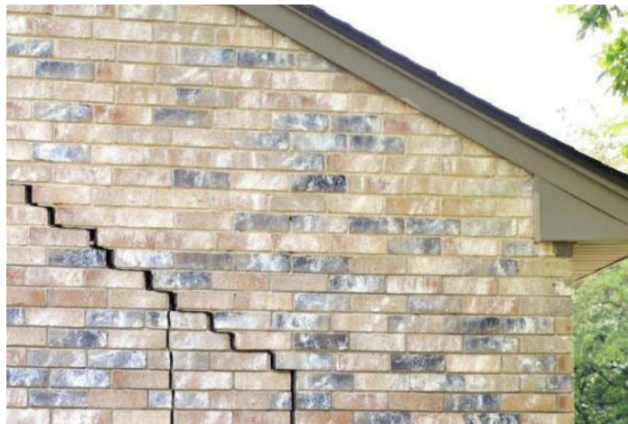
Figure I.5 : Fissure en escalier assez profonde, sur la façade d'une maison. La fissure suit clairement le joint des briques [7].
