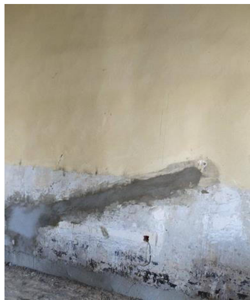
b) Traitement des fissures inclinées
