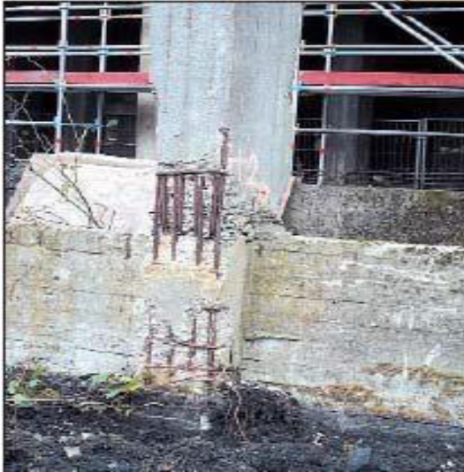
Figure I.13 : Corrosion des armatures par carbonatation [18].
