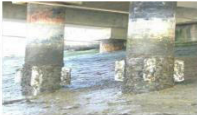
Figure I.15 : Pathologie des pieux due à l'attaque surfacique (eaux agressives) [22].
