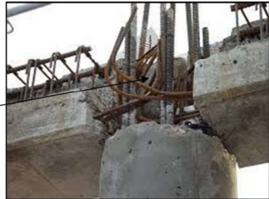
(b) Éclatement de béton
