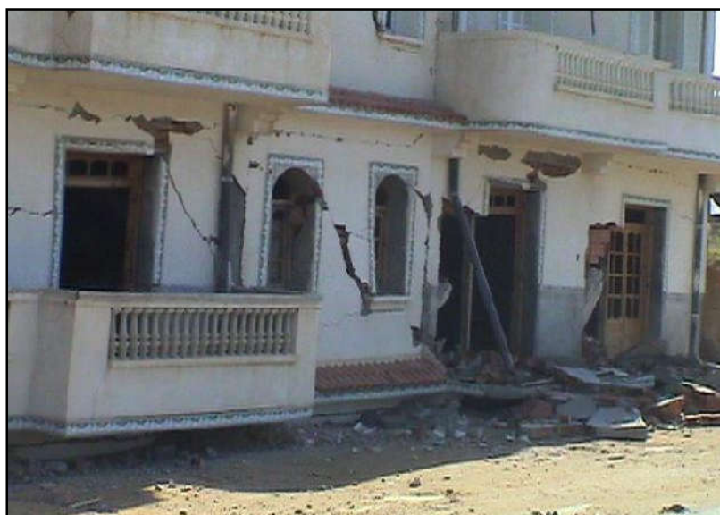
Figure I-21 : Effondrement complet de RDC (Étage souple) [13]
