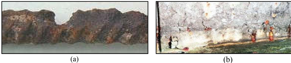
Figure I-8 : Conséquences de la corrosion par chlorures. [1] -[9]
