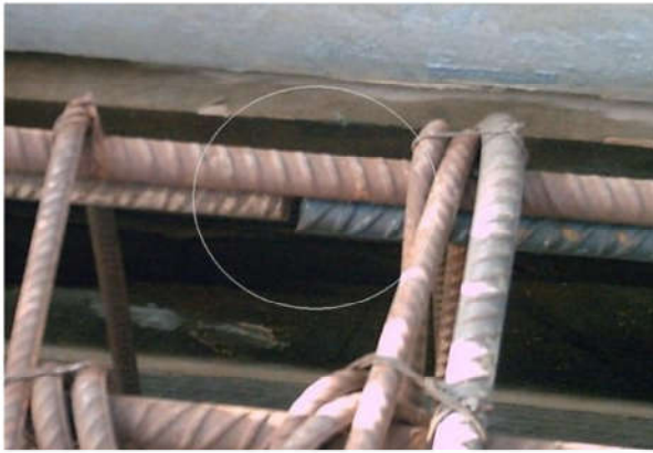
(c) Ferrailages trop courte au niveau de recouvrement
