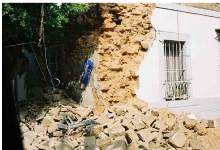
Photo 9 : les angles en maçonnerie sont très vulnérables (DELLYS)
