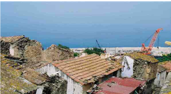
Photo 6 : planchers de faible intégrité (DELLYS)
