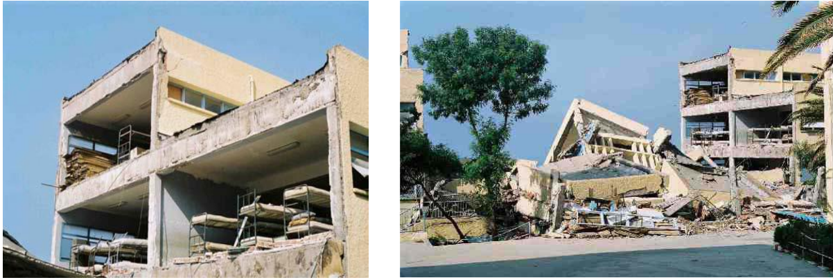
Photo 3 : Poteau fort –poutre faible (DELLYS)
