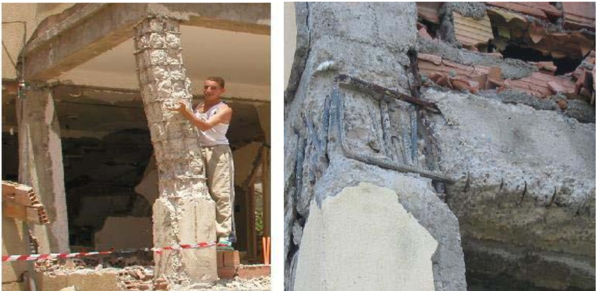
Photo 2 : absence des cadres à mi-poteau et au niveau des nœuds (ZEMOURI)
