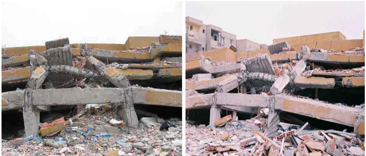
Photo 4 : l'effondrement totale en mille feuilles (BOUMERDES)
