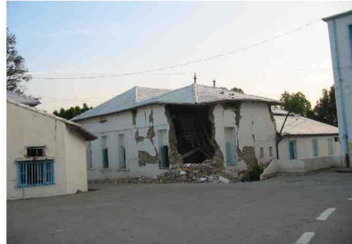
Photo 12 : l'effondrement des pignons faible (THENIA)
