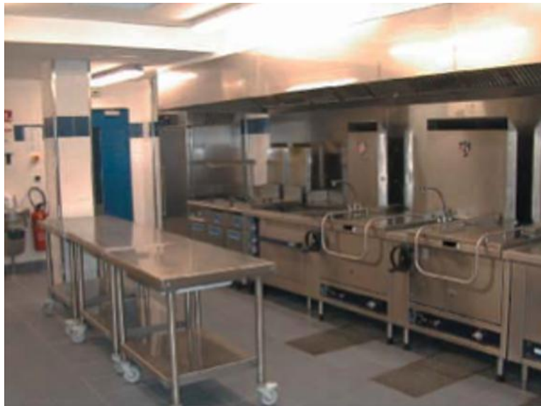
Figure 5.1: a -Le choix de l'acier inoxydable ,tant pour le mobilier que les parois , confrère à cette cuisine industrielle des qualités sanitaires répondant aux normes d'hygiène les plus exigeantes . L'acier inoxydables , inaltérable, se nettoie sans difficulté
