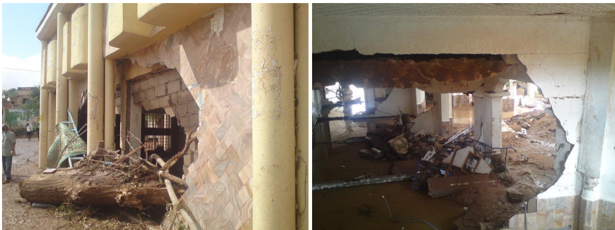
Figure III.25: Les inondations de la ville d'El-Bayadh en 2011
