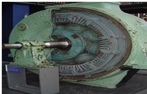
Fig. I. 9: Une génératrice synchrone de 2000 kVA datant de 1920
