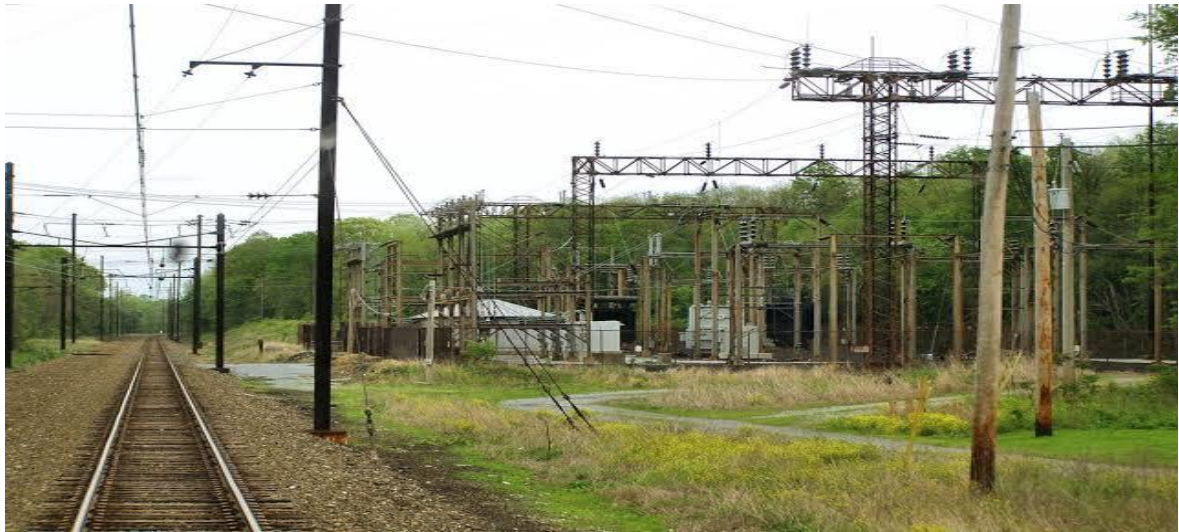
Figure 5 : Sous-station d'alimentation d'un réseau ferroviaire
