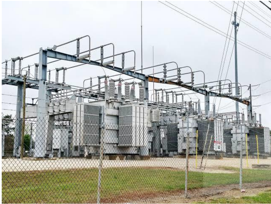
Figure 2 : Transformateurs à la centrale hydroélectrique. Ce poste alimente les lignes de transport électrique à 735 kV
