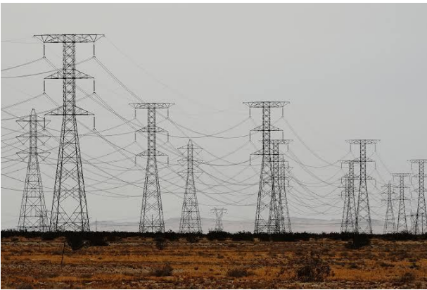
Figure 1 :Nombreuses lignes électriques aux abords d'un poste
