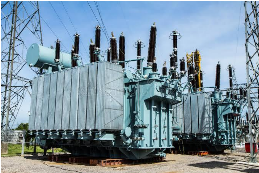
Figure 7 :Un transformateur de puissance dans un poste électrique
