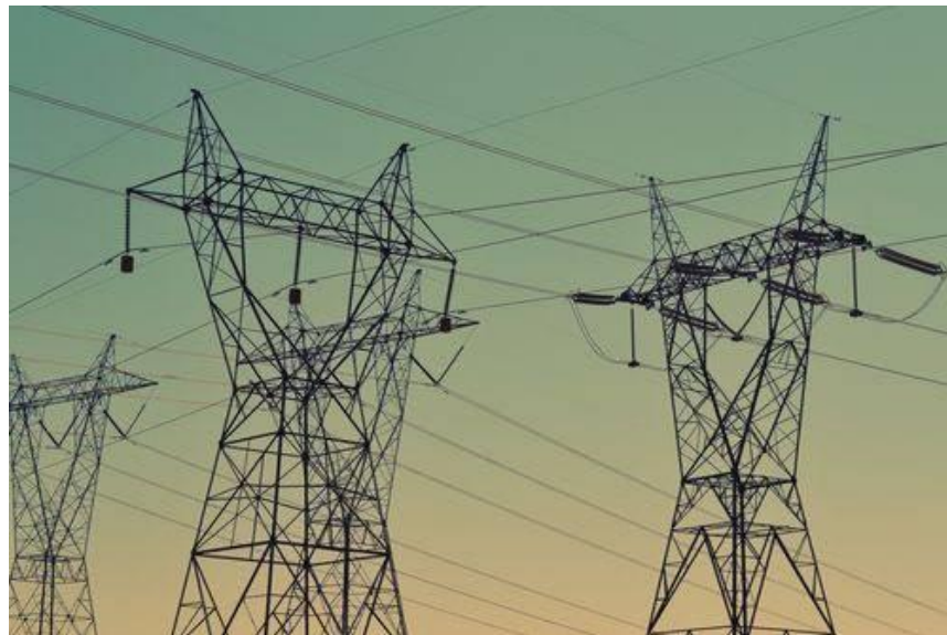
figure 11 : Une ligne de transmission d'énergie à quatre circuits et deux tensions (220/110 kV)
