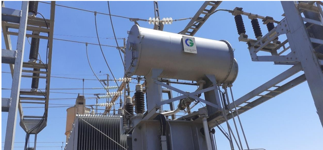
figure 3 : Le transformateur CG POWER
