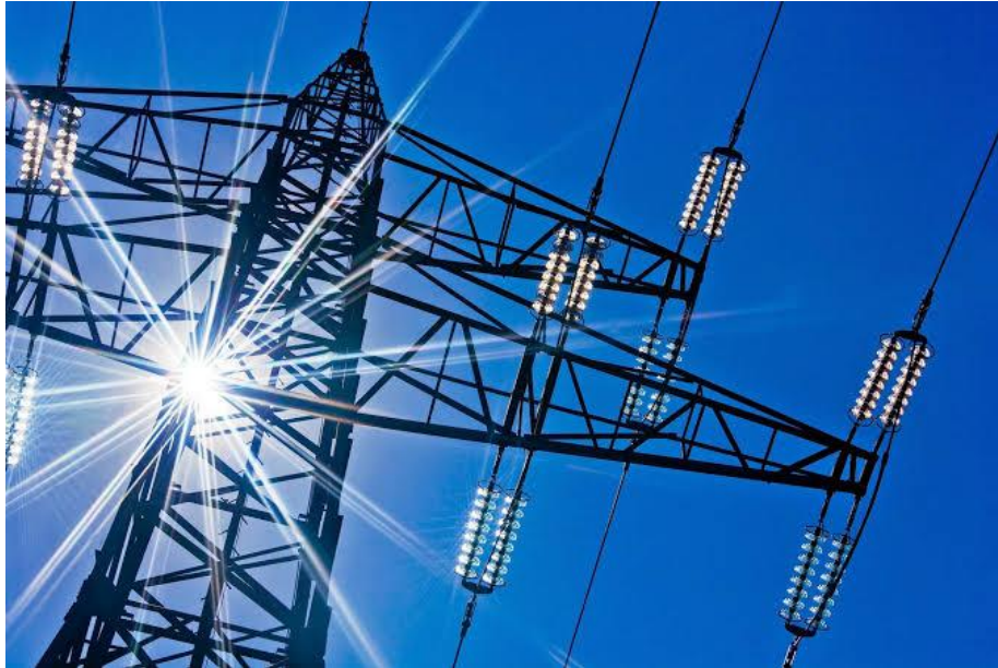
Figure 9 : 220 kV triphasé puissance électrique des Lignes de Transmission au Barrage de Grand Coulée
