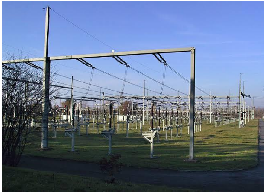
figure 23 : Jeux de barres d'un poste 400 kV.
