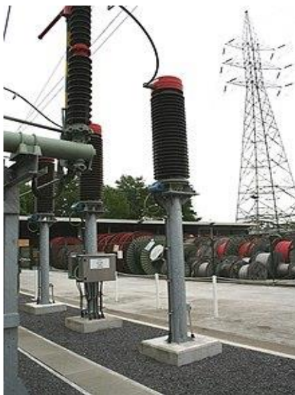
Figure 22 : Transformateur de tension, de tension nominale 60 kV.
