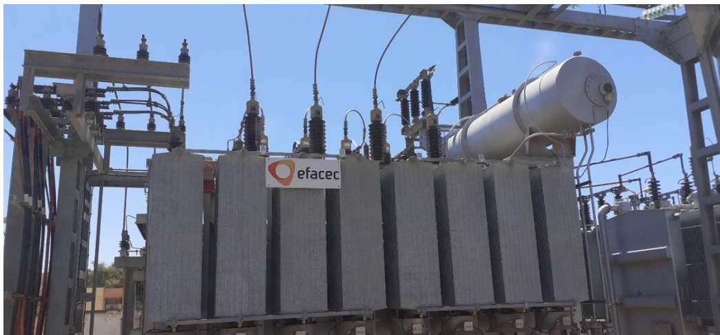
figure 2 : le transformateur dans la sous-station de Sidi Benhaoua
