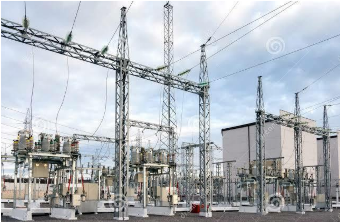
Figure 1 :Une module sous-station (220kv/60kv)
