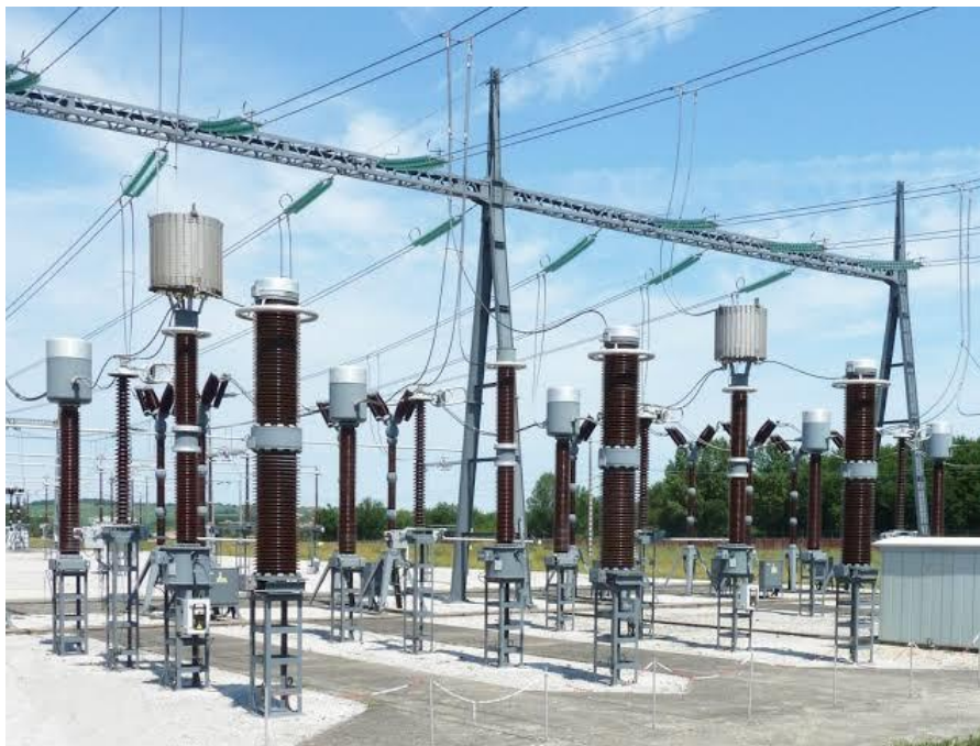
figure 26 : Installation pour le couplage d'un CPL sur un poste électrique 220 kV. On voit les circuits bouchons suspendus au portique et les condensateurs de couplage à leurs pieds.
