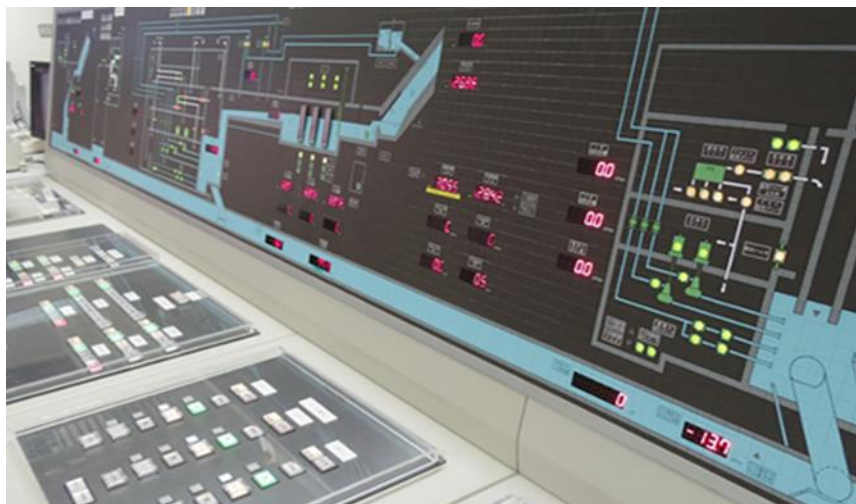
Figure V.4 : Le panneau de commande central du bâtiment d'approvisionnement en eau de Zenbukuji, préfecture de Tokyo 43
