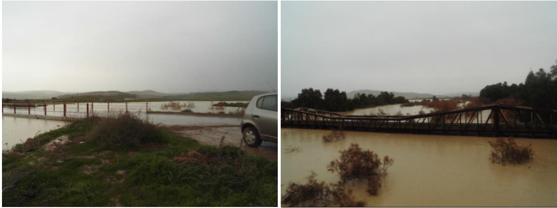
Le niveau des eaux atteint les ponts
