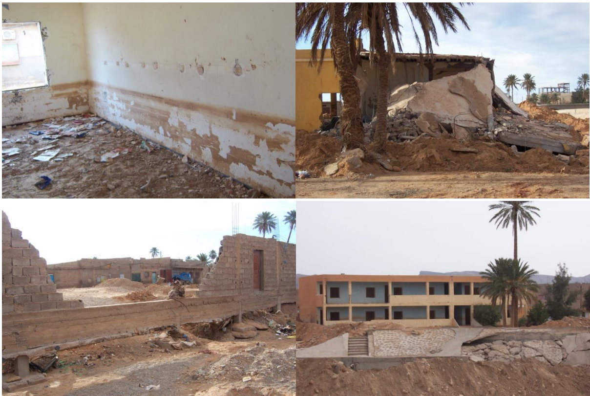
Figure III.3: Les constructions affectées par les crues à Béchar
