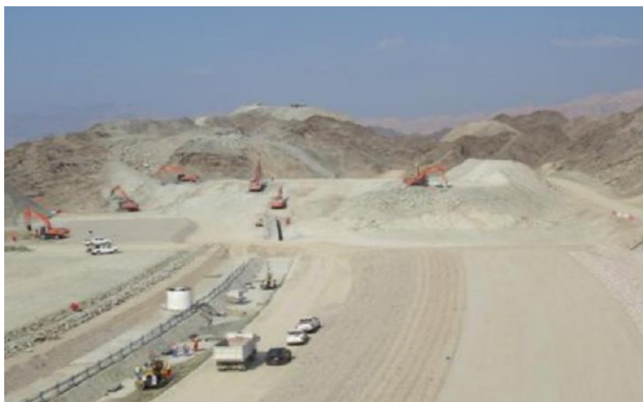
Figure V.1 : Mise en place de 4 barrages de protection contre les risques d'inondation au Sultanat d'Oman 40
