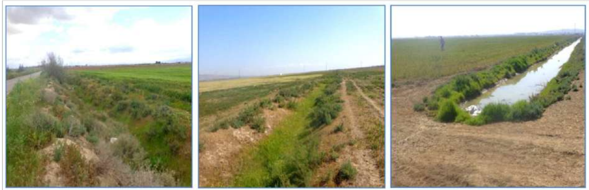
Figure 23b. Drains en état défectueux nécessitant un curage (Photos Berkane ; 2019)
