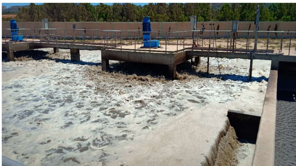
Figure II.5 : Bassin d'aération l'oxygène
