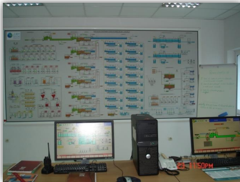
Figure II.11 : Salle de contrôle
