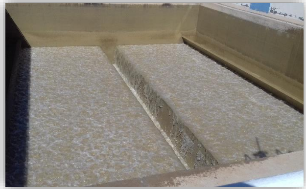
Figure. II.8 : Lavage d'un filtre
