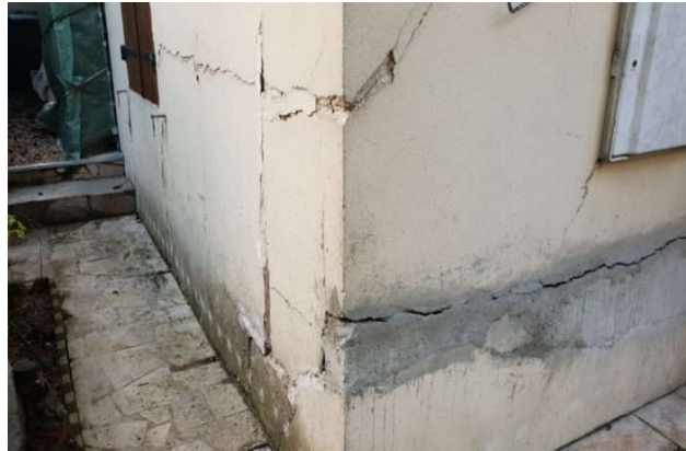
Fig. 3.6 - Fissures horizontales causées par la déformation de la chaussée.
