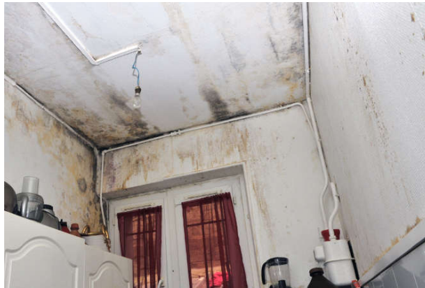
Fig. 3.5 - Efflorescences sur le mur d'une cuisine, Taches et moisissures dues à une mauvaise finition ou cloquage de l'enduit sur le mur par remontée capillaire.
