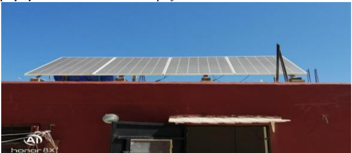
Fig46: les panneaux solaires
