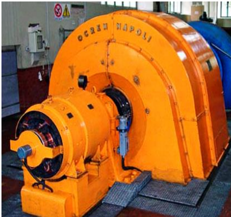
Fig15 :Alternateur d'une centrale hydraulique. [21]
