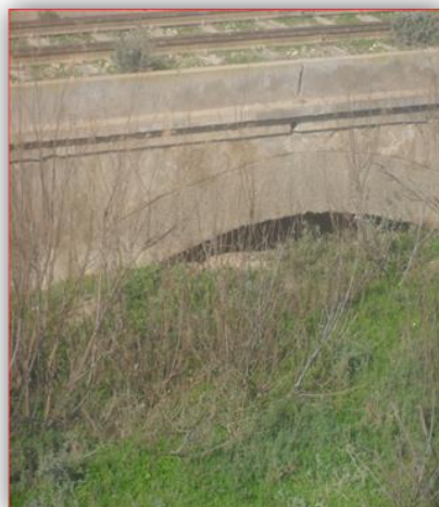
Figure : Section complètement colmatée par envasement.
