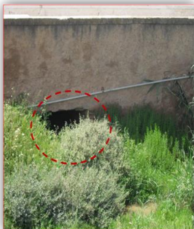
Figure : Section Complètement colmatée par végétation.
