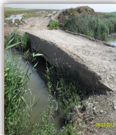
Figure : Ponceau empêche l'écoulement de l'oued.
