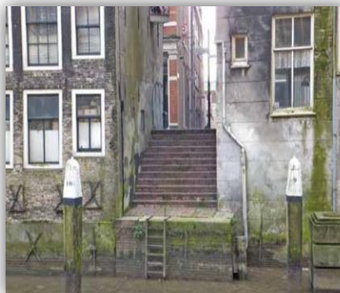
Figure 73: les sentinelles de l'inondation le long de la Voorstraat dike.
