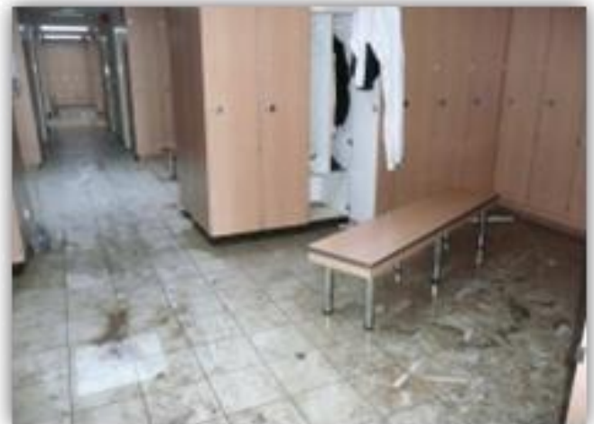
Vestiaires après l'inondation
