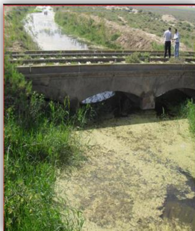
Figure : Pente faible et stagnation d'eau
