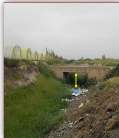
Figure : l'ouverture de ponceau gêne
