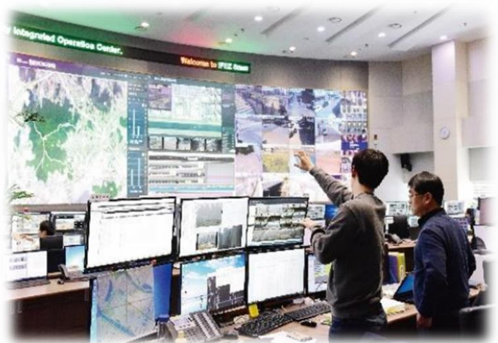
Figure 32: : Le centre de contrôle des opérations intégrées du Songdo, source : www.kpf.com
