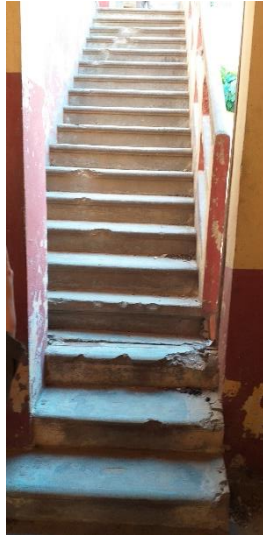
Figure 61 : Escalier extérieur du bâtiment n 03
