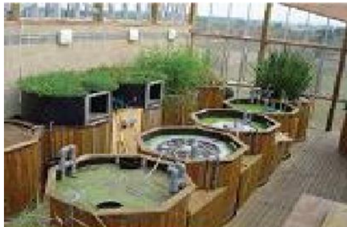
Figure 41 : les cuves de l'épuration des eaux usée. (couché. (sd) ,2016)
