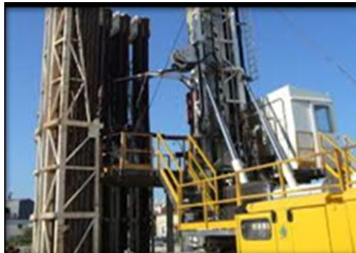
Figure 57 : les puits géothermiques du fort d'Issy. (Institut national de l'économie circulaire ., 22 juin 2018)
