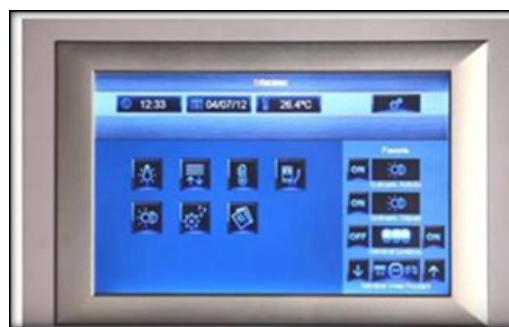
Figure 53 : le système de gestions du fort d'Issy. (Institut national de l'économie circulaire ., 22 juin 2018)
